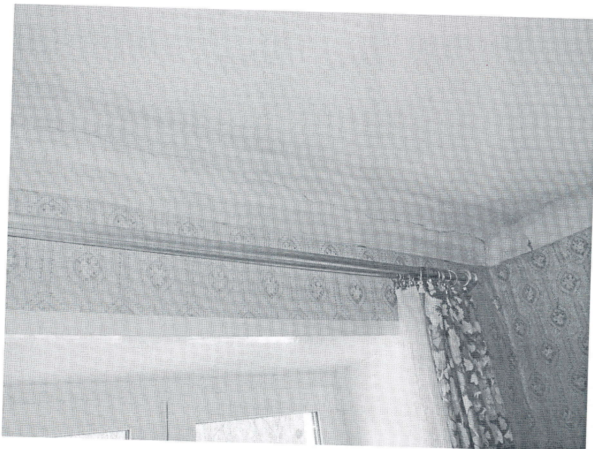
Фото №11. Угловая комната. Трещина на потолке.
